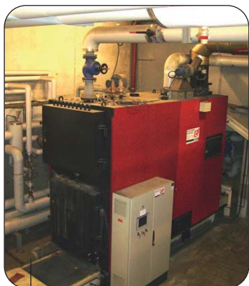
La chaudière COMPTE.R. de 1,2 MW
